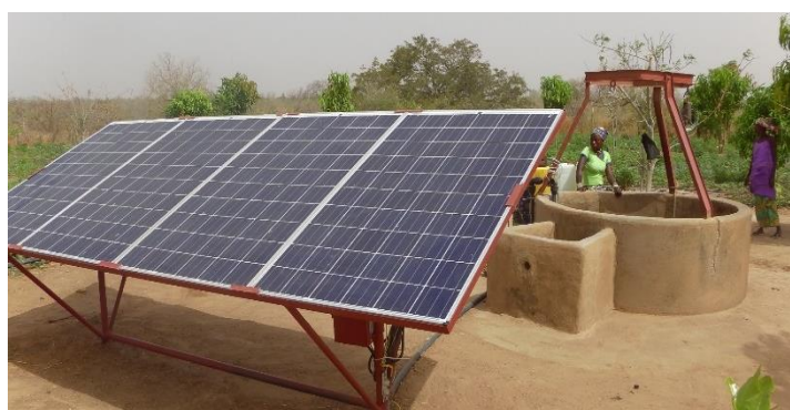
Une pompe solaire avec un système d'exhaure installée dans le village de Dianécounda
